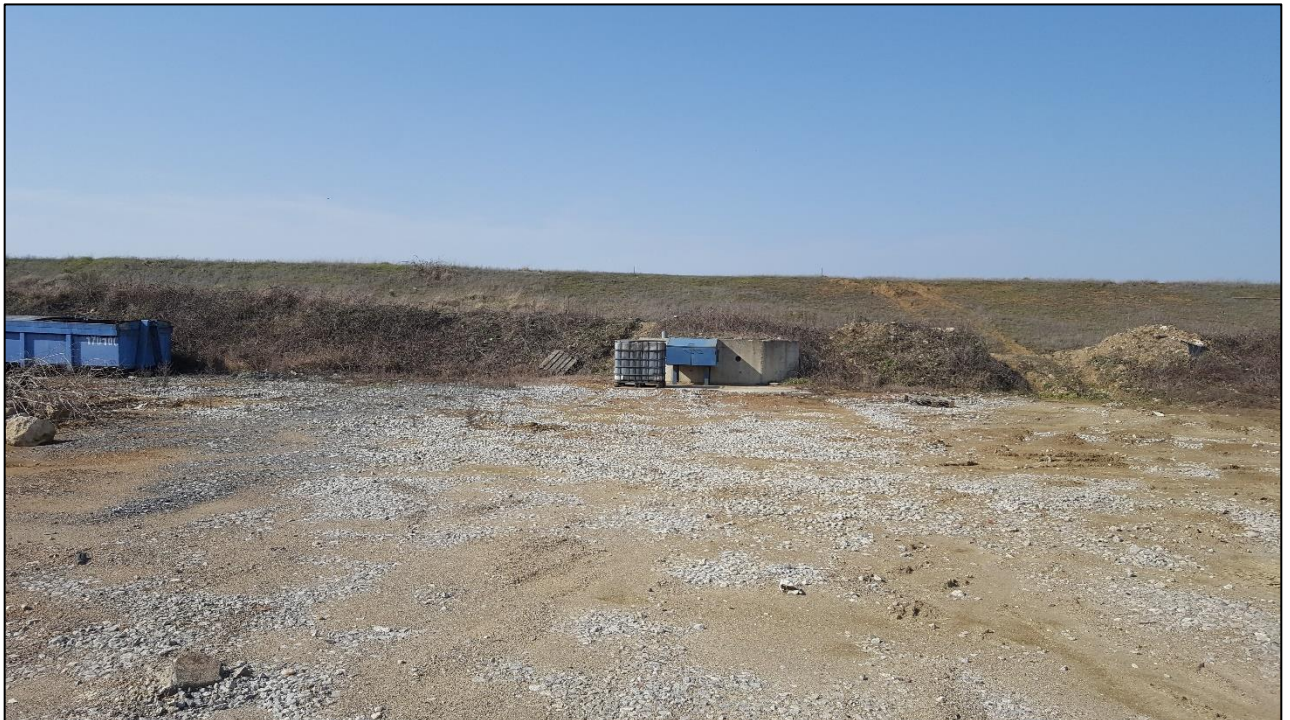
Photo de deux colonnes d'aspiration de la réserve d'eau incendie de 2000m 3
